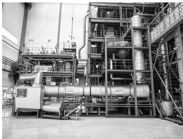
图2 水泥窑富氧掺氢燃烧试验台
